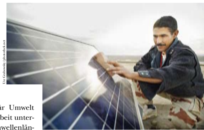
Die Kraft der Sonne nutzen: Solaranlage einer Photovoltaikanlage in Marokko
